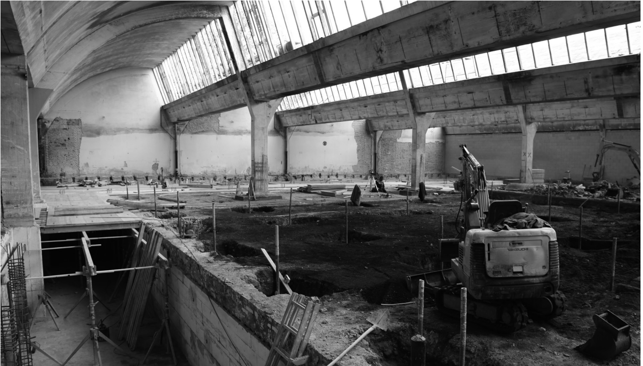
Die Magazine des Stadtarchivs Augsburg vor und nach den Umbauarbeiten: Austausch der Bodenplatte und Einbau von Mikropfählen zur statischen Traglastsicherung in den Shed-Hallen (Foto: Stadtarchiv Augsburg).
